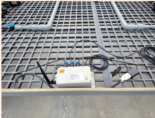
▲圖 3.栽培床上設置灌溉管路物聯網土壤濕度計。
