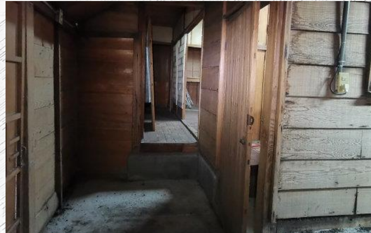
縁側門扇佚失
