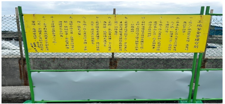
進入工區危害告知
