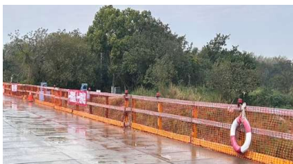
鋼管護欄及防護網
