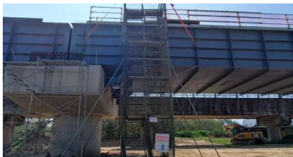
人員安全上下設備
