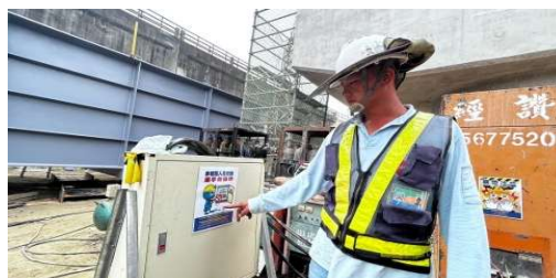
電器開關箱檢查
