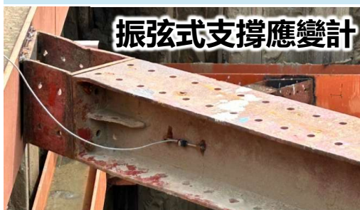
觀測便橋水平支撐安全
