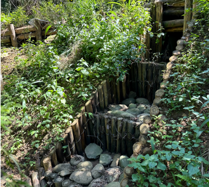
#1截水溝 (B、C排水分區排水出口)
