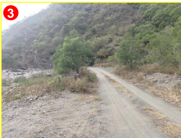
3 水流易漫淹，影響路基
