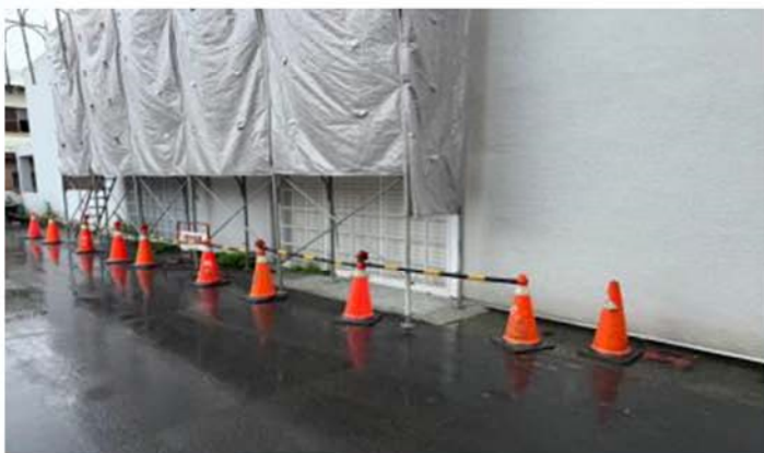
社區內加強施工架安全措施
