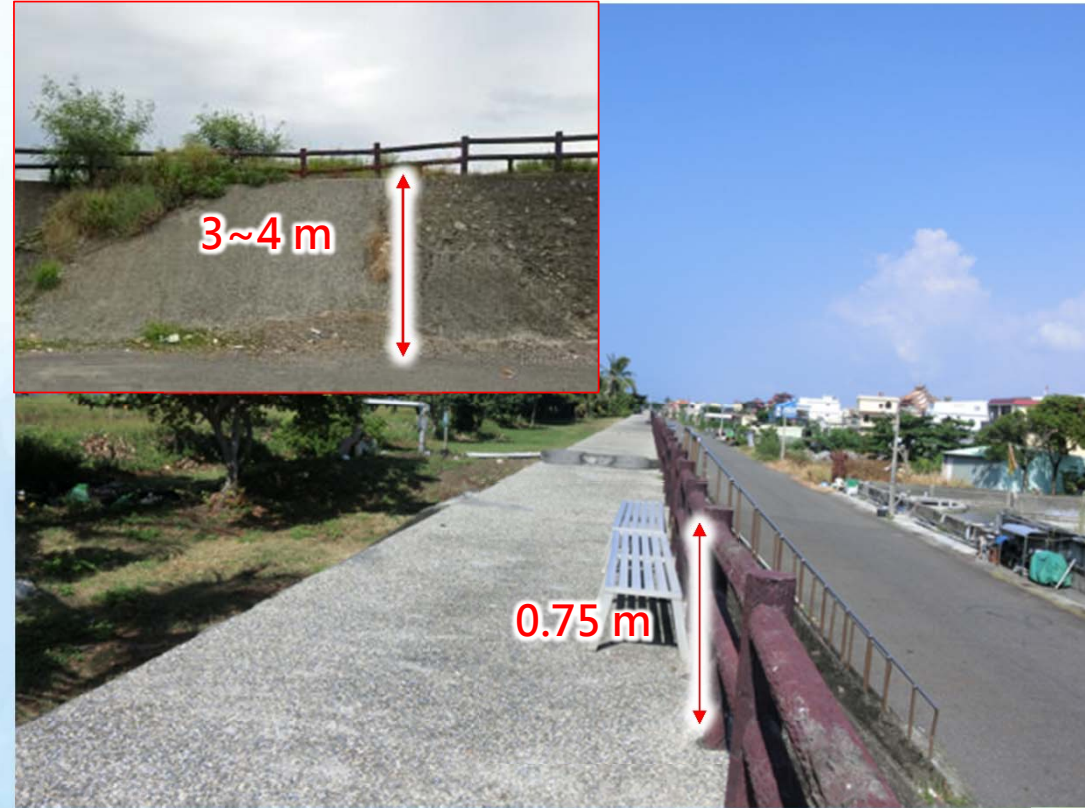
既有欄杆高度低矮易墜落
