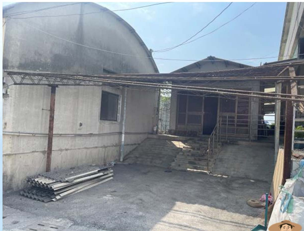
設施破損 產業外移
