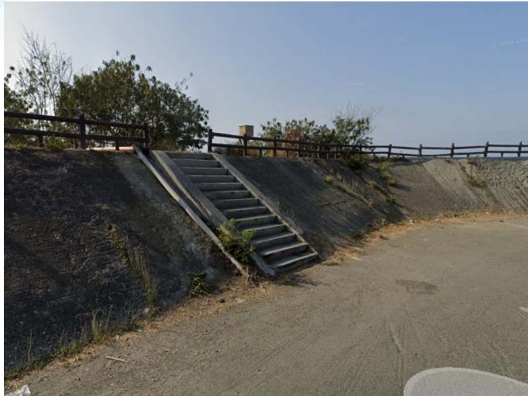
無緩坡通道 缺階梯扶手
