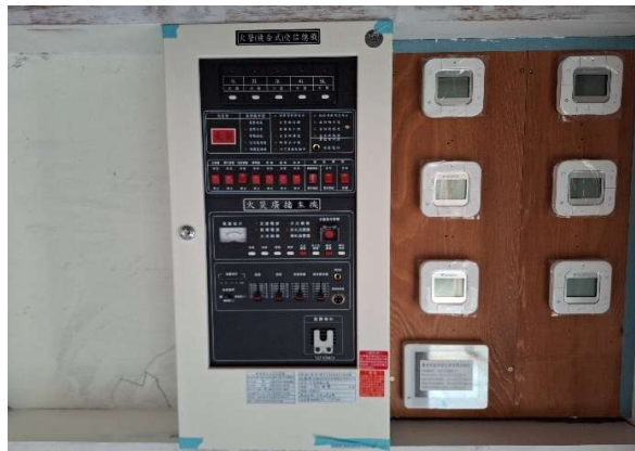
(1)電氣設備-押入配置配電盤、消防受信總機、空調分控與除濕機開關
