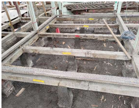
(2) 木構件損壞構件調查 及標示色帶
