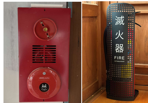
(1)火警備設備-火警綜合盤、滅火器
