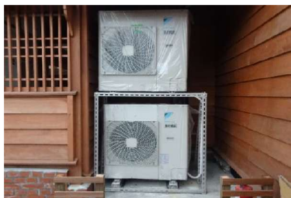
(2)空調、除濕設備系統-室外機
