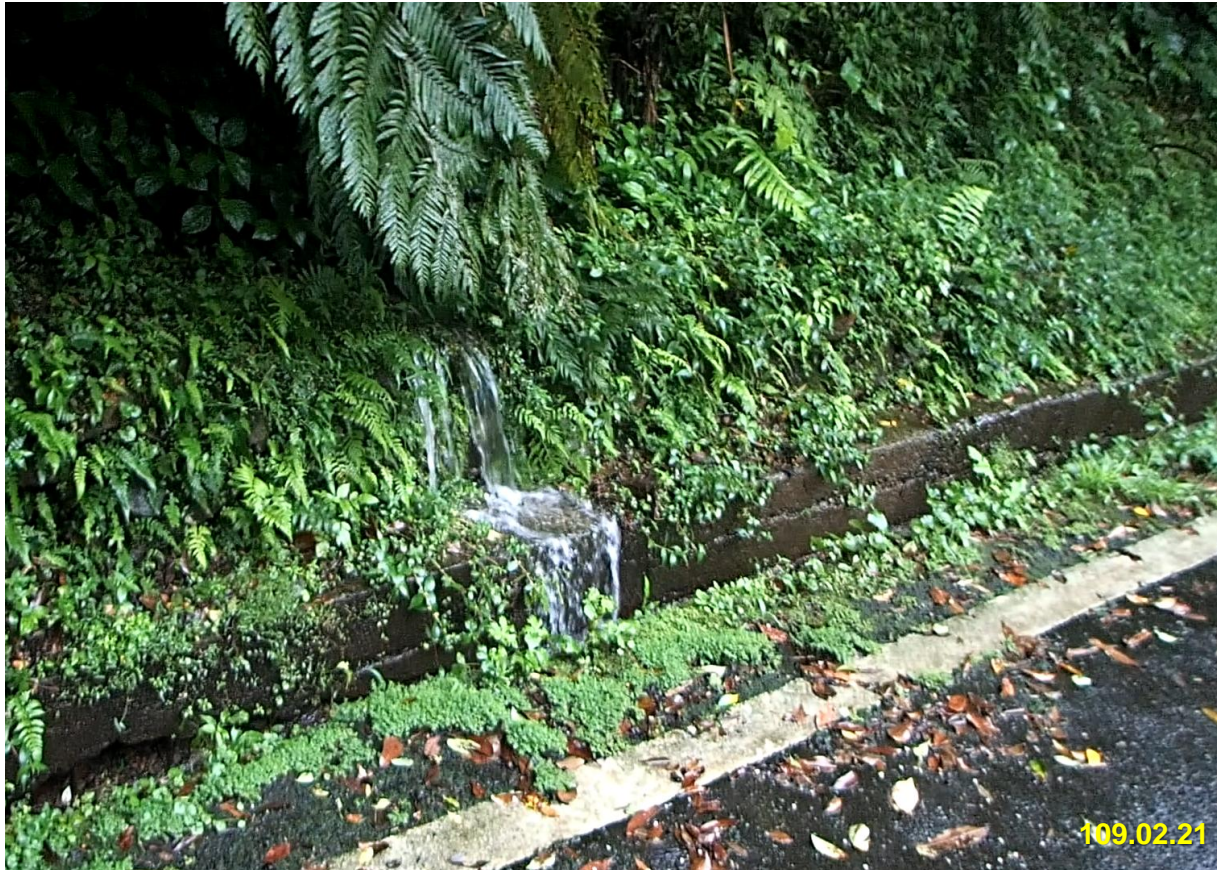
坡面滲流易造成淺層滑動情形
