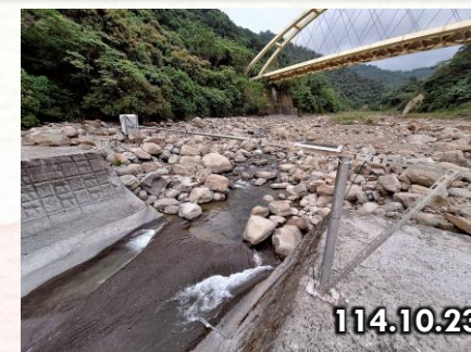
新美大橋下游水位及濁度計
