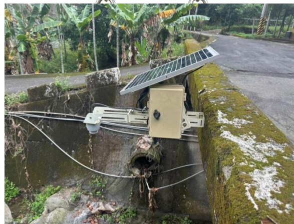
上游設置監視器及水位計
