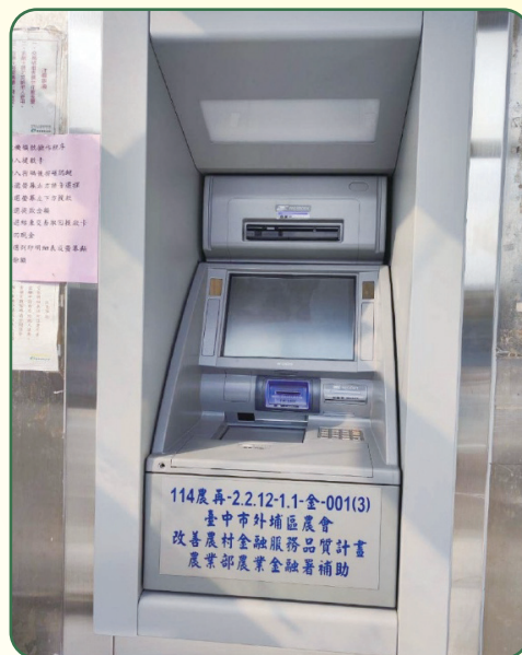
▲ 輔導臺中市外埔區農會土城分會汰換信用部穿牆式自動櫃員機
