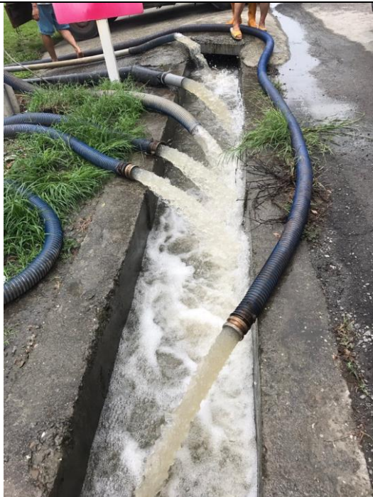
淹水後儘速進行排水作業
