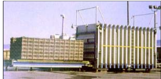
中型真空預冷機操作情形
