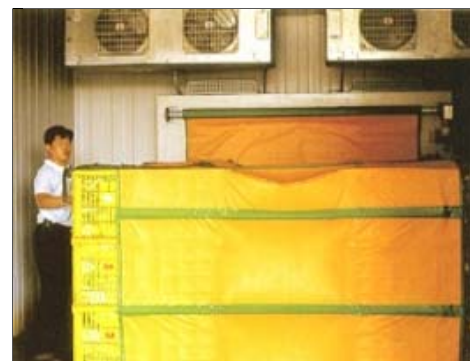
中型隧道式壓差預冷庫操作情形
