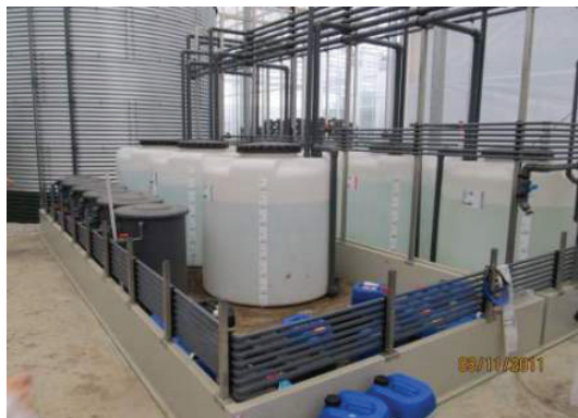
圖 9. 各區溫室的養液調配儲存桶
