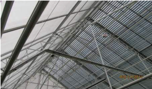
圖 13.溫室屋頂百葉板太陽能加熱管路
